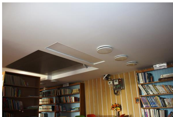
Technické zázemie vzduchotechniky
